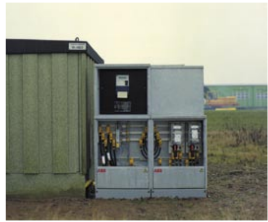
Jaotuskapp ühendatud tuulegeneraatori jaotusseadmega, Halmstad, Rootsi.
