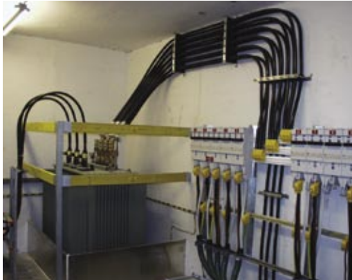
Kabeldon IP20 latid on monteeritud alajaamas otse seinale, Trondheim, Norra.
