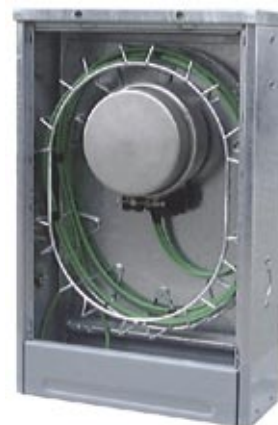
Kiudoptilise kaabli kerimisalusega varustatud kaablijaotuskapp.
