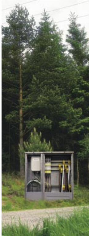
Jaotuskapp CDC kasutusel elektri- ja fiiberoptikavõrgus (juurdepääsuvõrk).
