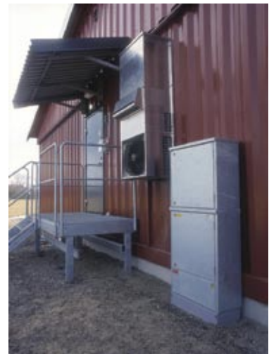
SDCM 648 jaotusseade installeeritud telekommunikatsiooni toiteks Lõuna-Rootsis.
