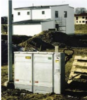
Kaablijaotuskapp elektrienergia ja kaabeltelevisiooni jaotamiseks uuselamurajoonis, Rootsi.
