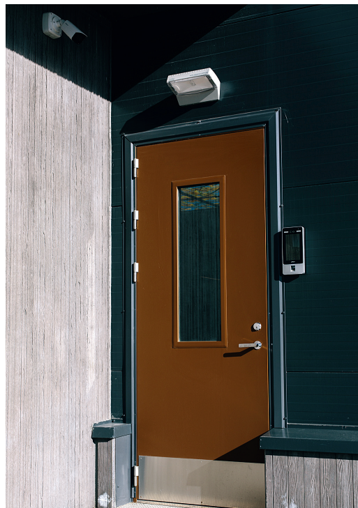
Pilt 5. Evakuatsioonivalgusti välisukse kohal tagab hoonest ohutu väljumise
